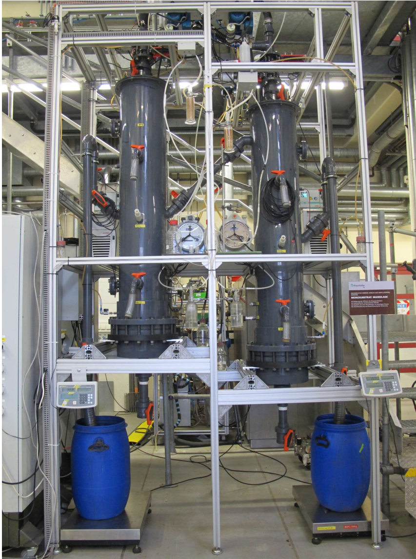
Abbildung 13: Die zwei Biogasanlagen HLF (links) und REF (rechts) im Technikumsmaßstab. Links im Bild die seitliche und rückwärtige Ansicht der Schaltschränke.
