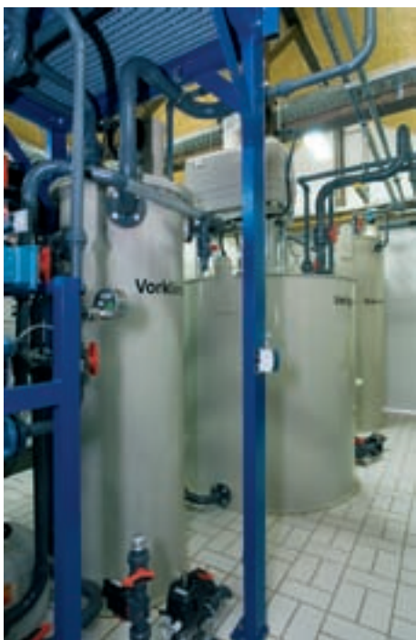
Bild 1: Die gesamte Technik der Membrankläranlage Heidelberg-Neurott findet Platz im ehemaligen Feuerwehrgaragehaus.
