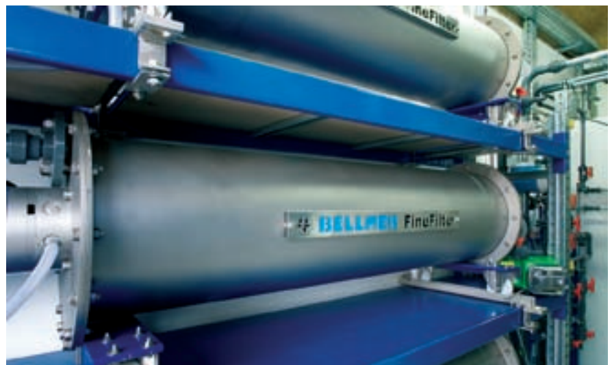
Bild 3: Großtechnischer Einsatz des Rotationsscheibenfilters.
