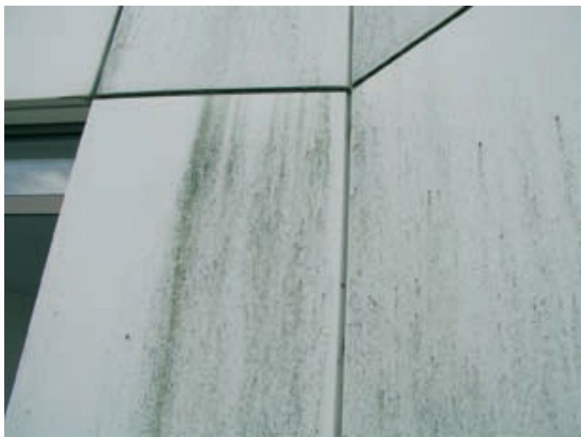
Bild 1: Mikrobiell besiedelte Fassade.
