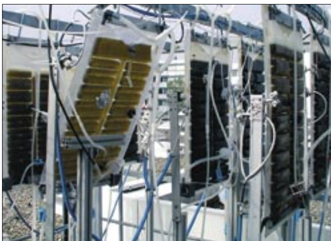
Bild 3: FPA-Reaktoren der Freiland-Produktionsanlage auf dem Institutsgelände in Stuttgart.
