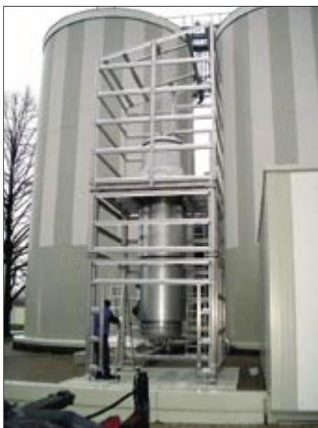
Bild 3: Pilotanlage im Aufbau: Schlaufenreaktor zur Vergärung von Klärschlamm.
